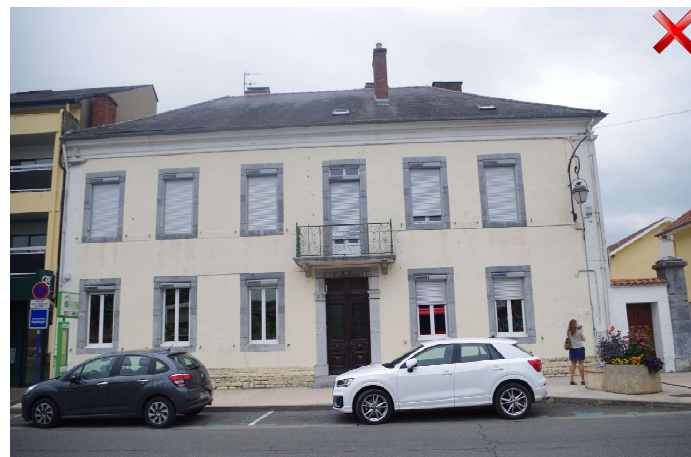
Façade appauvrie - perte de rythme avec la suppression des volets
